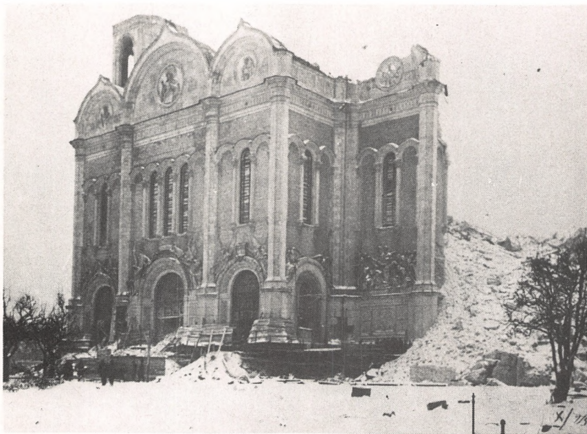
Основной взрыв произведен. Сохранилась наружная стена, разрушенная последующим взрывом. Все внутри разрушено.
